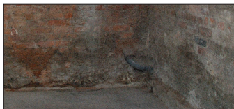
Ściana Zachodnia - zawilgocona z uszkodzeniami fundamentów z wikwitami solnymi. Stan z października 2009 przed pracami zabezpieczająco - uzupełniającymi. The Western Wall – with the foundations partly damaged, damp and bearing salty efflorescence. Stan z października 2009 przed pracami zabezpieczająco - uzupełniającymi.
