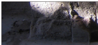
Fragment Ściany Wschodniej pokazujący duże nierówności, sypiące się stare fragmenty muru i zawilgocenia. Stan z października 2009 przed pracami zabezpieczająco - uzupełniającymi. Detail of the Eastern Wall showing extensive unevenness, parts of the mortar falling off and damp spots.
